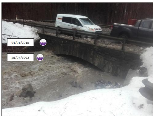
Photo montage avec repères de la crue du Verney, pont du Verney RD4, 04/01/2018
